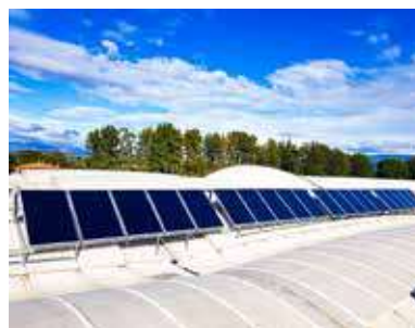
Venti collettori solari piani provvedono al pre-riscaldamento dell'ACS, per un fabbisogno di picco pari a oltre 200 docce in 4 ore
