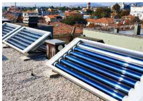
La copertura piana ripresa alla conclusione dei lavori di installazione degli impianti: in primo piano i collettori solari termici per la produzione dell'ACS
