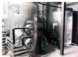
I bollitori per pre-riscaldamento e preparazione dell'ACS: la circolazione continua notturna di acqua a 60 °C opera un efficace trattamento anti-legionella
